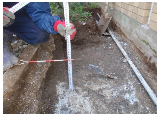
写真2.) 縁石天端 25 cm下がり
