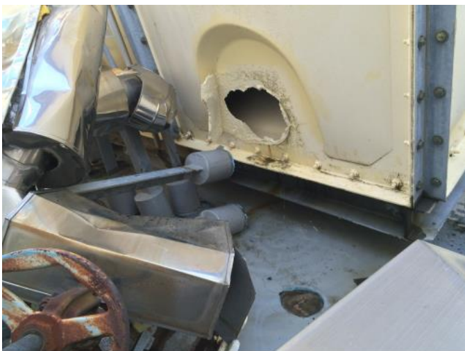
<壊れた高架水槽、復旧は60日後になる（熊本市中央区）>
